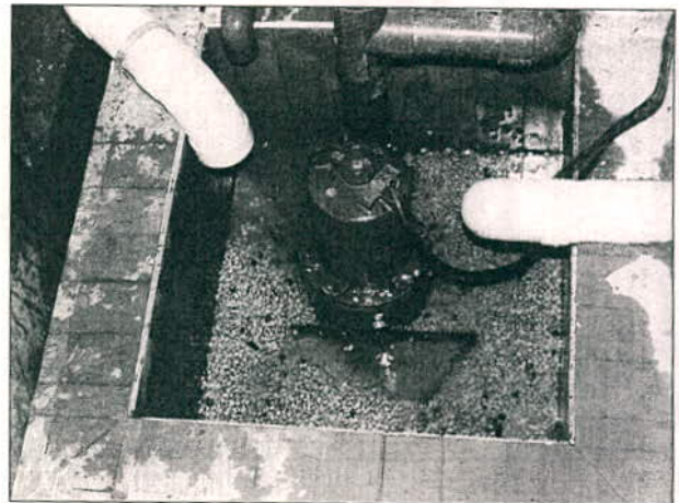
Figura 26. Motobomba sumergible utilizada para el lavado y transporte del café.
