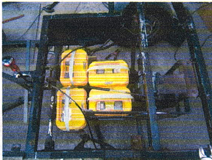
Fotografía 5. Soporte de las baterías. Vista superior
