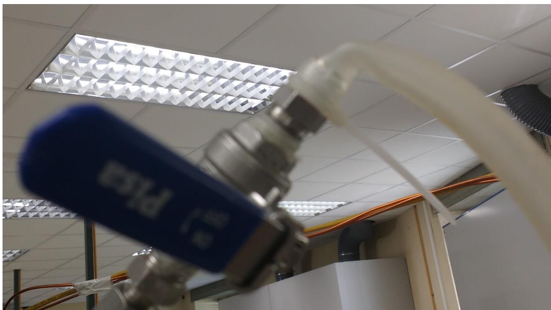
Figura 18: zona dónde se detectó una de las fugas del sistema (conducto de entrada de gases al digestor)
