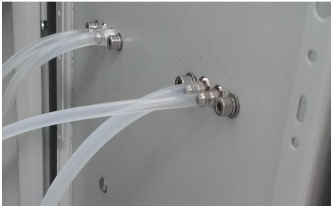
Figura 17: zona dónde se detectó una de las fugas del sistema (interior del caudalímetro)
