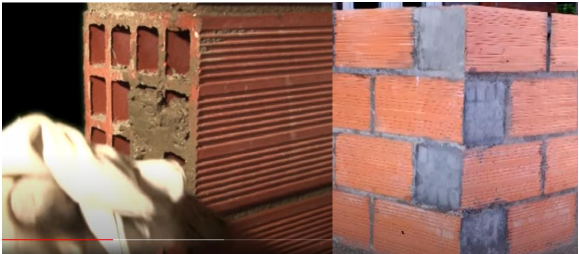
Ilustración D – La imagen de la izquierda corresponde a una persona tapando los canales de los bloques (minuto7:15), la imagen de la derecha muestra los canales de los bloques completamente sellados (minuto 7:19)
